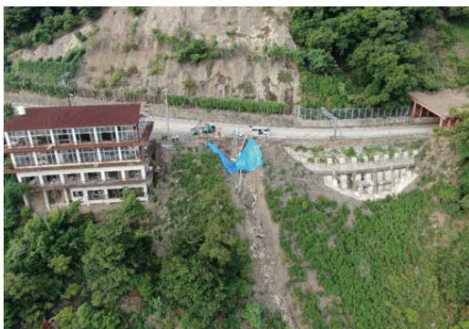
国道8号の被災状況
