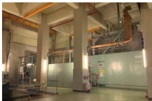
非常用発電設備
